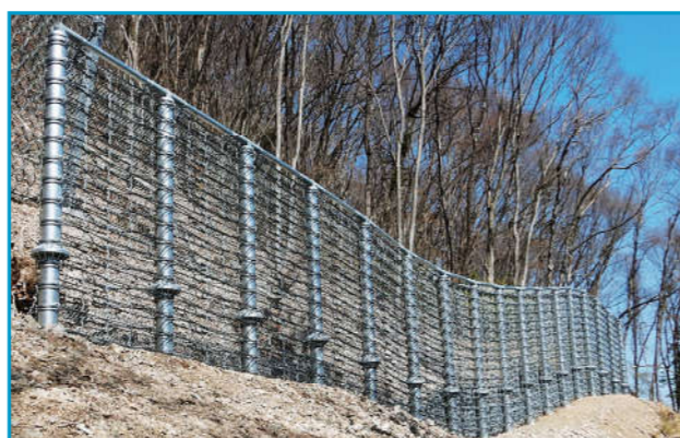
発注者 長野県上田建設事務所 工事件名 令和2年度 防災・安全交付金(急傾斜地崩壊対策)(緊急対策事業)工事(急)和子 上田市 和子 施工箇所 長野県上田市和子 施工延長 40m 落石エネルギー 1007kJ
