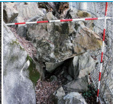
2016年 奈良県 落下高さ: 40m 落石形状: 1.0m×0.8m×0.6m 推定落石エネルギー: 320.6kJ 捕捉後の状態: 性能2(部材に変形・損傷が生じたものの、当該部材の交換により機能回復)
