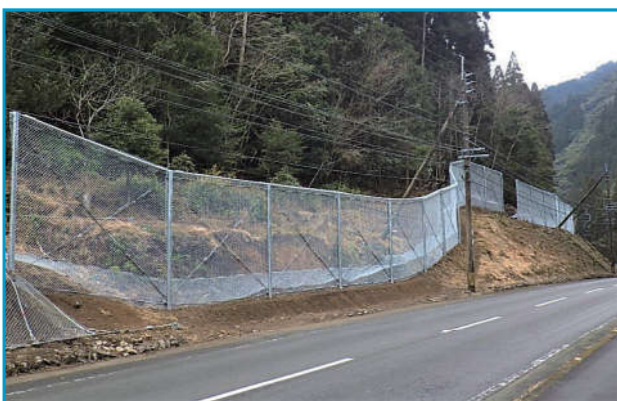
発注者 宮崎県日向土木事務所 工事件名 令和2年度防国法第955-9-17-2号国道446号小又吐工区道路防災工事(その2) 施工箇所 宮崎県東臼杵郡美郷町南郷大字水清谷 施工延長 130m 落石エネルギー 94kJ
