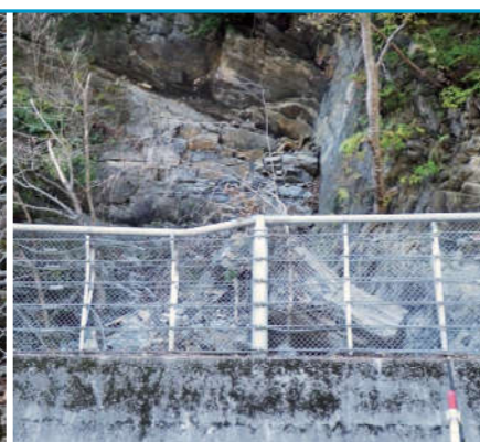
2016年 岩手県 落下高さ: 15m 落石形状: 2.0m×1.5m×2.5m 推定落石エネルギー: 260KJ 捕捉後の状態: 性能2(部材に変形・損傷が生じたものの、当該部材の交換により機能回復)
